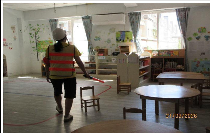
說明：負責人員進入校園內檢視建築物受損情形。
