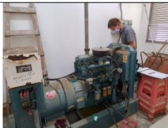
說明：檢視消防設備是否運作正常。
