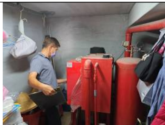
說明：檢視消防設備是否運作正常。
