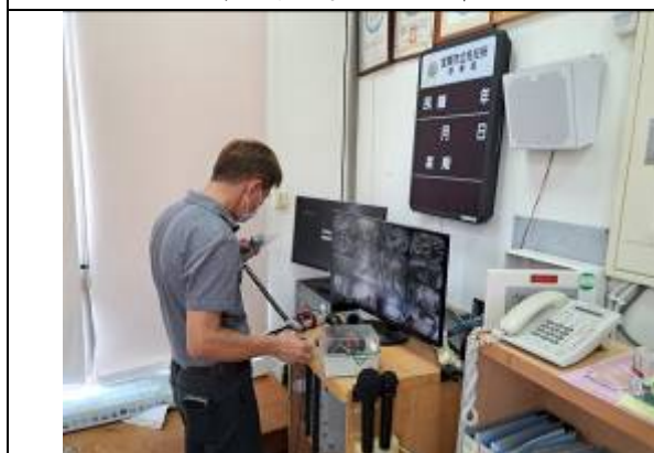
說明：測試消防受信系統是否能正常運作。
