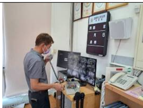
說明：測試消防廣播系統是否能正常運作。
