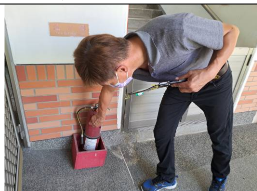
說明：檢視滅火器是否在有效期限內。
