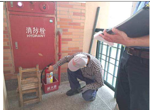
說明：檢視滅火器是否在有效期限內。
