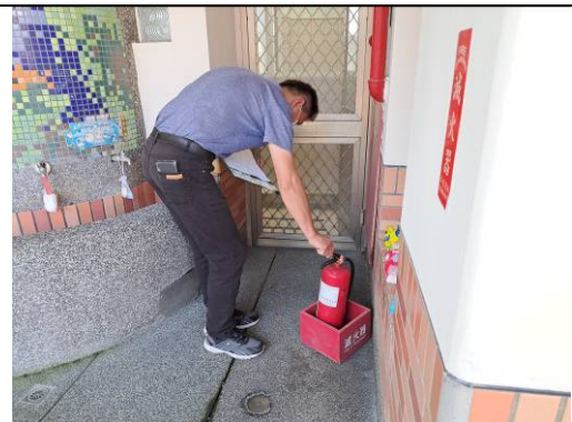
說明：檢視滅火器外觀是否有無損壞。
