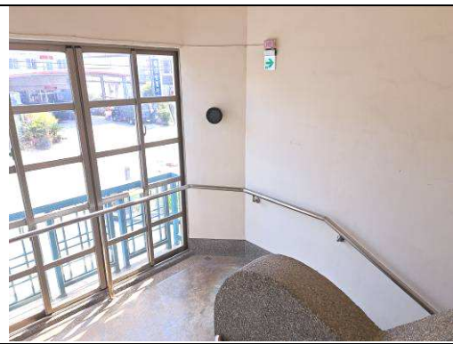
說明：樓梯間轉角設有照明燈。
