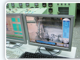
進水口的即時監測 ▲
