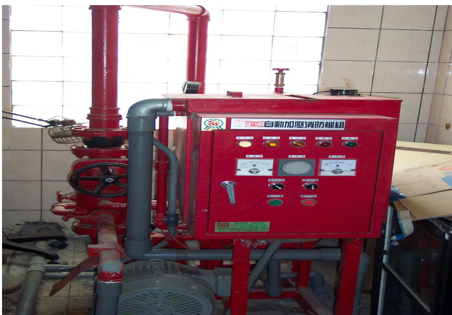
消防設備-消防泵浦
