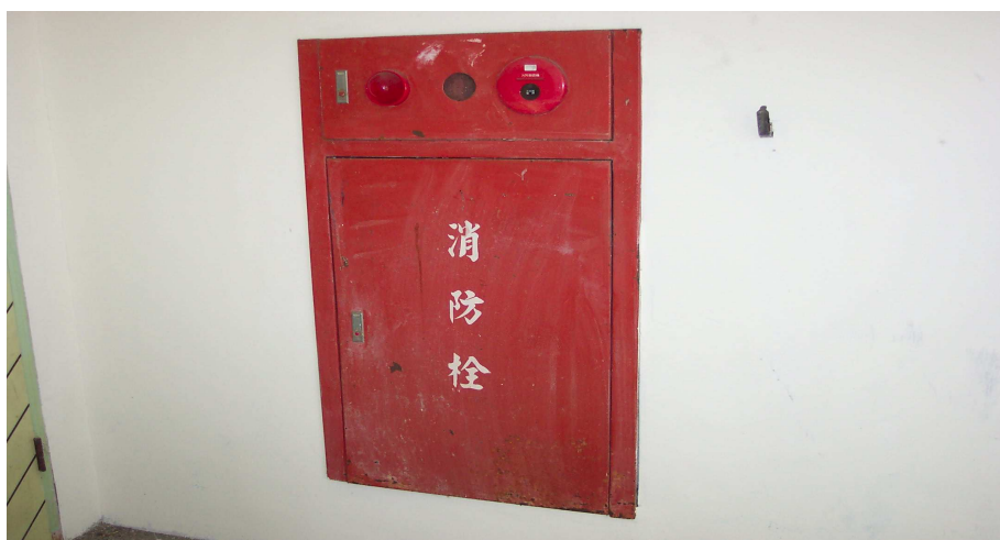
消防設備-消防栓
