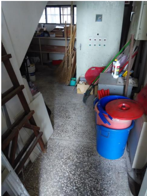
學務處旁電器室
