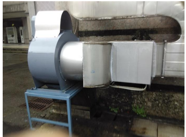
更新廚房多翼式風車及靜電式除油煙機 (新)
