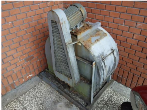
更新廚房多翼式風車及靜電式除油煙機 (舊)
