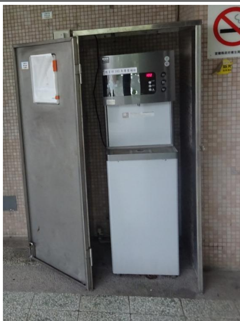
教學大樓西側一樓飲水機
