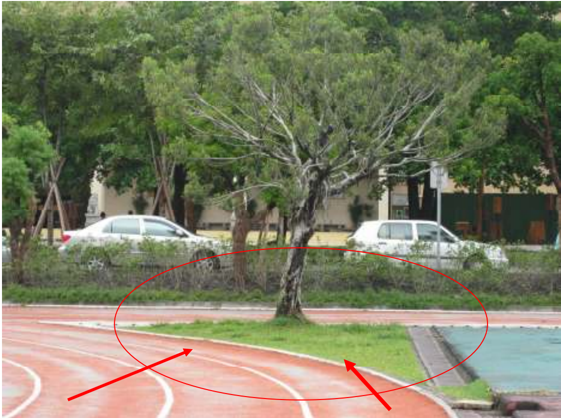
現況三、樹種根莖抓地甚深且已延伸至田徑場跑道，已造成部份地面隆起
