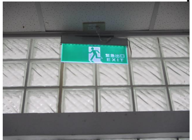
緊急避難指引換裝 LED 燈省電裝置
