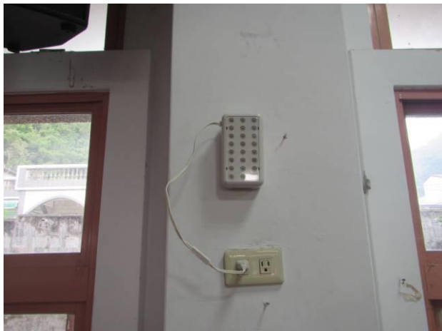
緊急照明燈換裝 LED 燈省電裝置
