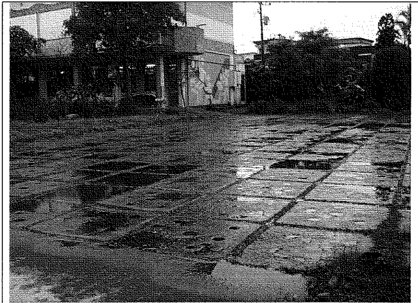
雨天過後到處積水的現況
