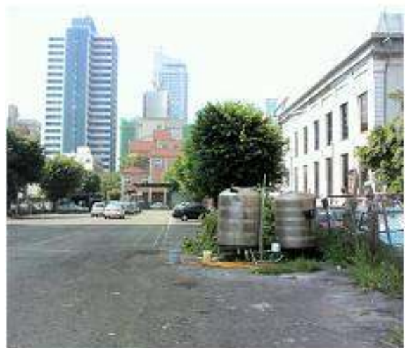
停車廠水塔無蓋
