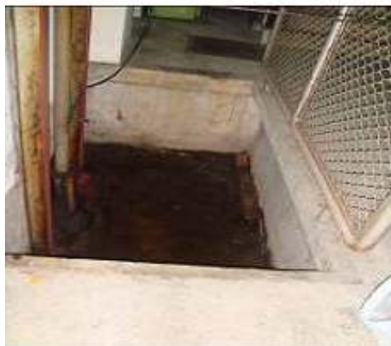
地下室之升降梯孔積水
