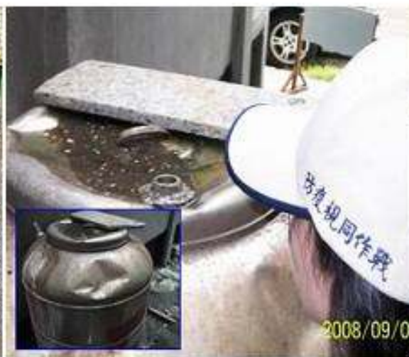
儲水桶鐵蓋凹陷處
