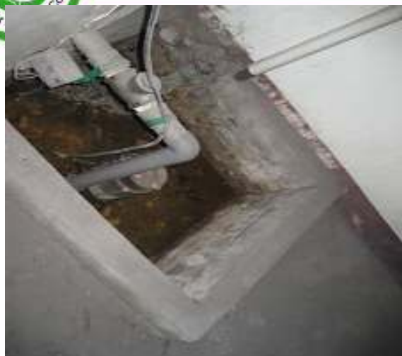
地下室儲水槽
