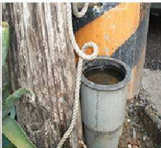
台電地下電纜引上管
