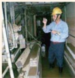
圖為行政院原能會人員進入核四現場了解受影響設備的狀況。 照片來源：行政院原能會
