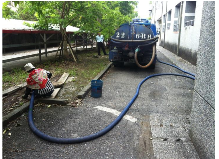
化糞池汙水處理-2
