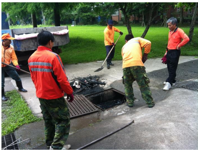
化糞池汙水處理-1
