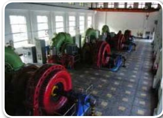
天埤廠內有4部發電機
