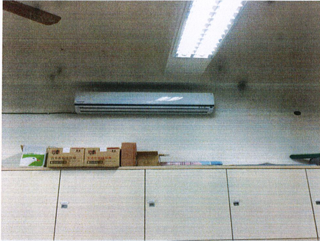
※無風管空調機提供新室內機(含空間)照片
