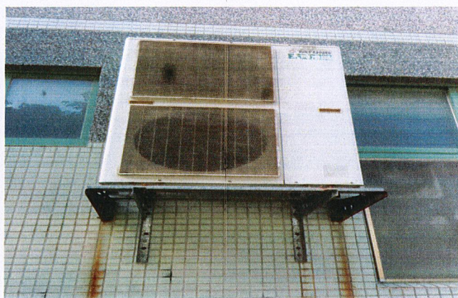
※無風管空調機提供原室外機型號近照
