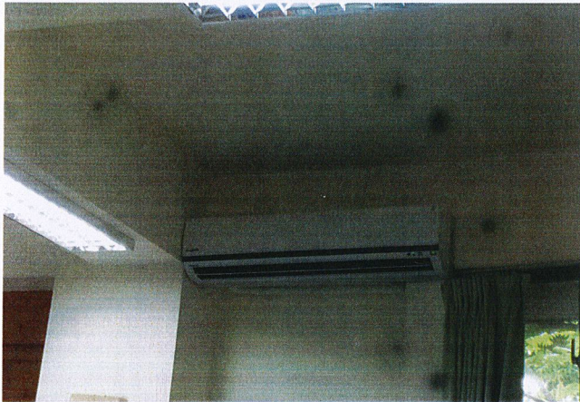
※無風管空調機提供新室內機(含空間)照片
