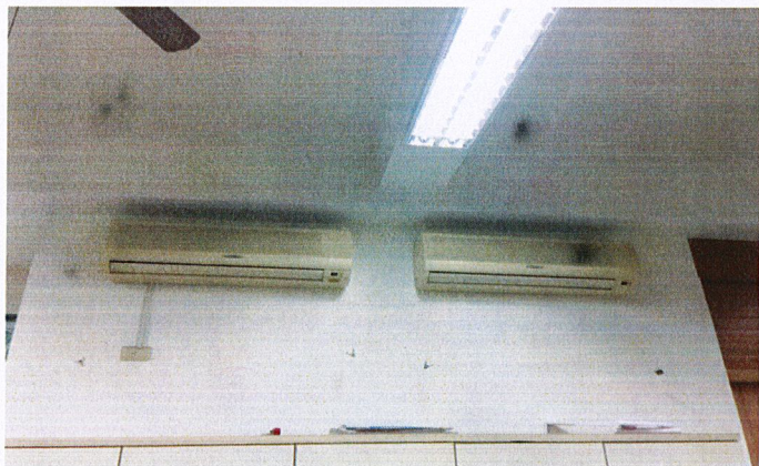
※無風管空調機提供原室內機(含空間)照片
